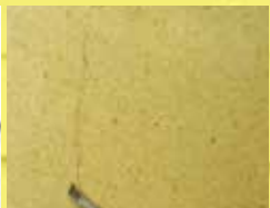
ヒビ割れがある
